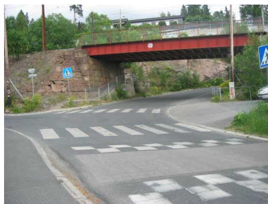
Bilde 23 (høyre): Undergang T-bane (nyopsatt gjerde til venstre under brua)
